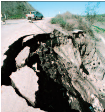
Dégâts provoqués par un séisme.
